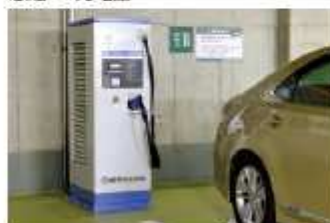
急速EV充電器
