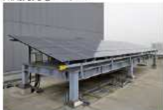
太陽光発電システム
