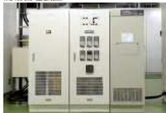
供給管理装置
